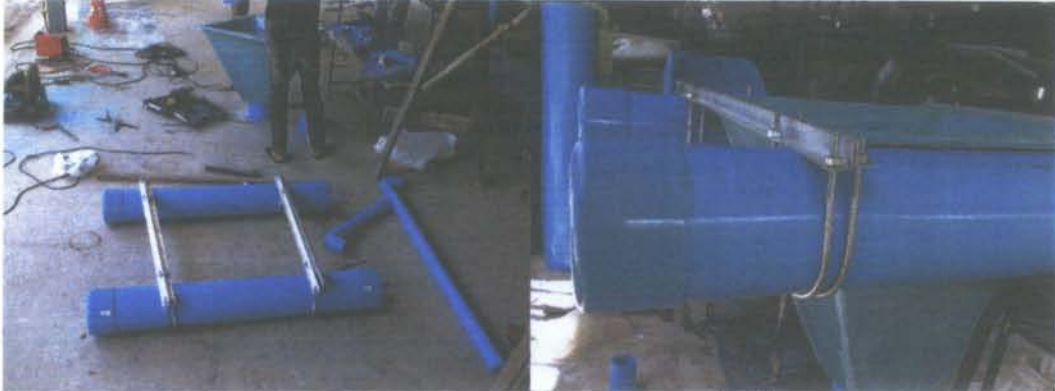
รูปที่ 2.2 แสดงการจับยึดท่อนลอยและห้องมอเตอร์ปั้มน้ำเข้าด้วยกัน
