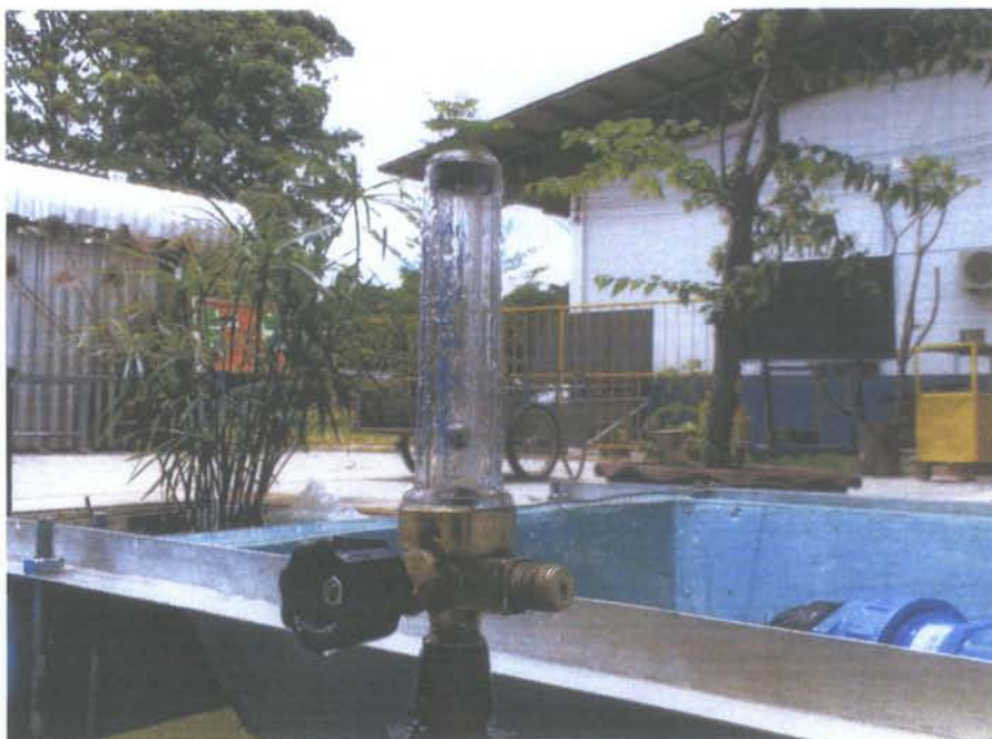
รูปที่ 3.11 การวัดอัตราการไหลของอากาศที่ถูกดูดผ่านท่อดูดของเครื่องกลเติมอากาศ
