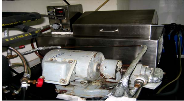
รูปที่ 22. เครื่องผลิตน้ำมันร้อนและปั้มน้ำมันร้อน.
