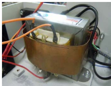
รูปที่ 3.52, การนำแผ่นทองแดงมาพันรอบหม้อแปลงไฟฟ้า และต่อลงสายกราวด์.
