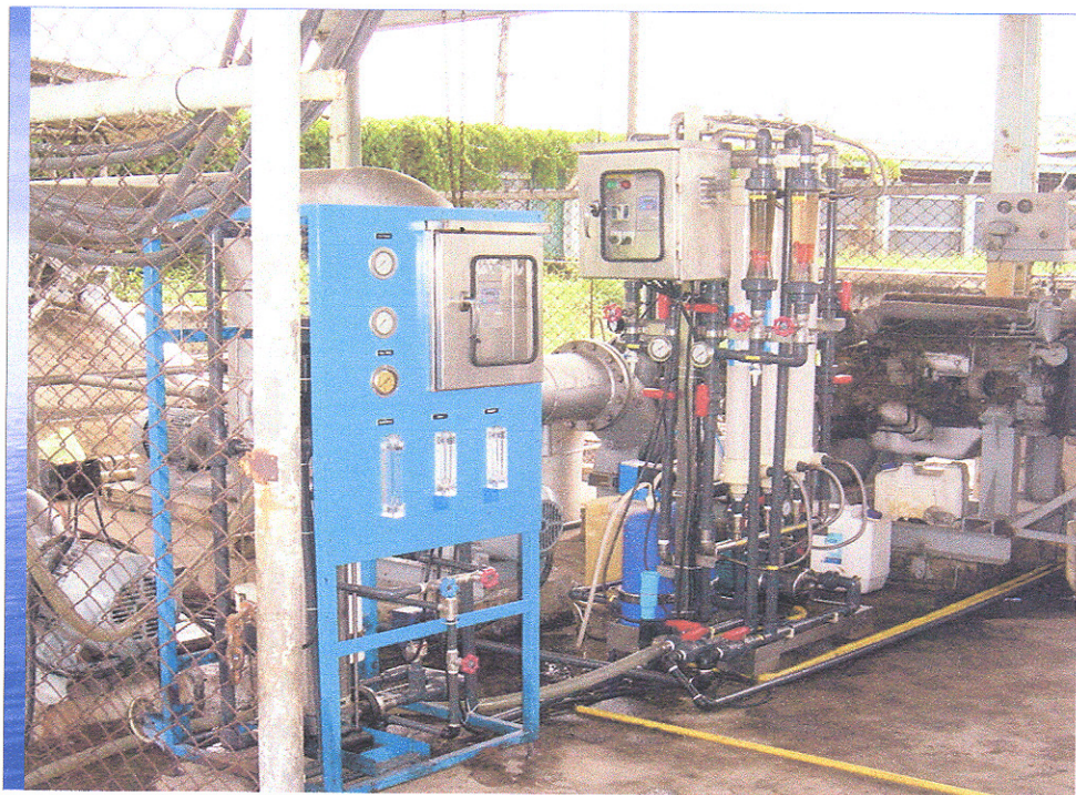
รูปที่ 13. ระบบบำบัดน้ำเสียระบบ Integrated Membrane System เพื่อการนำน้ำกลับมาใช้ใหม่.
