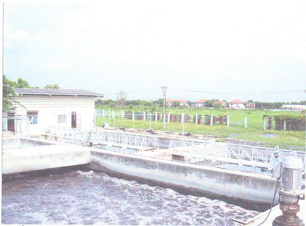
รูปที่ 12. ระบบบำบัดน้ำเสียแบบตะกอนเร่งที่ใช้กับอุตสาหกรรมฟอกย้อมต่างๆ ไป.
